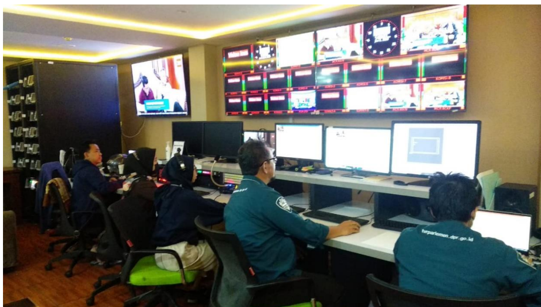
Ruangan Master Control Room (MCR) TVR Parlemen yang berfungsi sebagai pusat kendali siaran televisi
